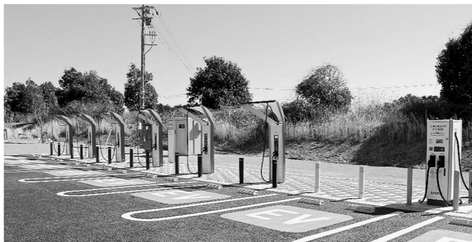
設置が進む充電器
